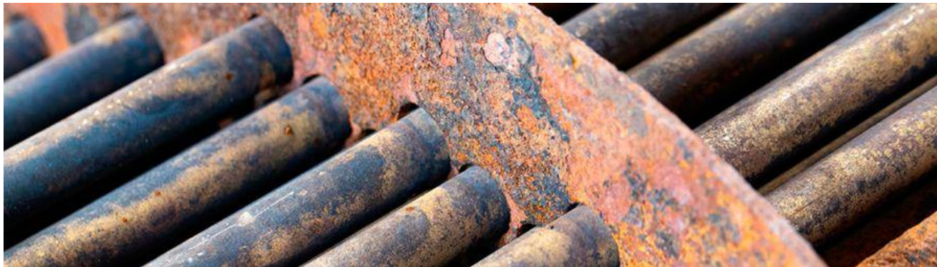
ボイラ鋼管燃焼ガス 中腐食
